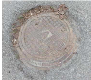
Figur 14. Tillsynsbrunn med sättningskada (Diameter 45 cm).
