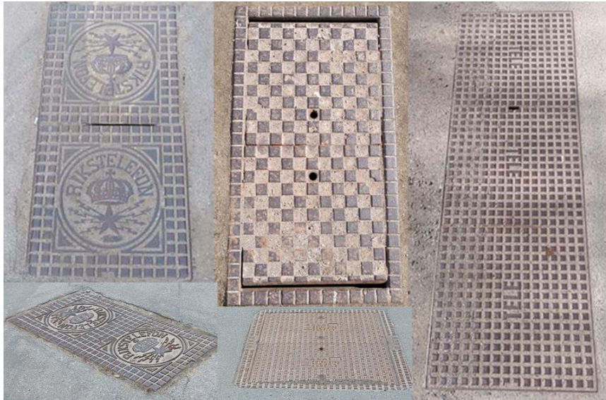
Figur 10. Ett urval av kabelbrunnar. En kvadrat är här sidan 80 cm så de med tre i rad blir således 240 cm långa.
