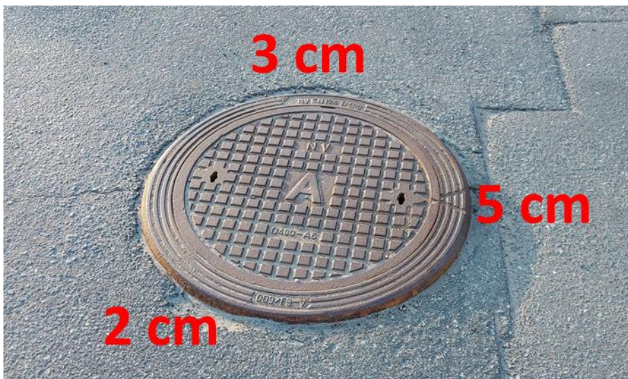
Figur 27. Höjdskillnaden mellan brunnslocket och asfalten i centimeter på olika sidor av brunnslocket.
