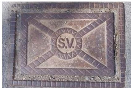
Figur 11. Servisventil till flera fastigheter, huvudventil (35*50 cm)
