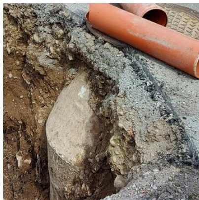
Figur 12. Mannhålsbrunn, urskärning. Brunnens läge är fixerad medan det i beläggningen kan uppstå sättningar.
